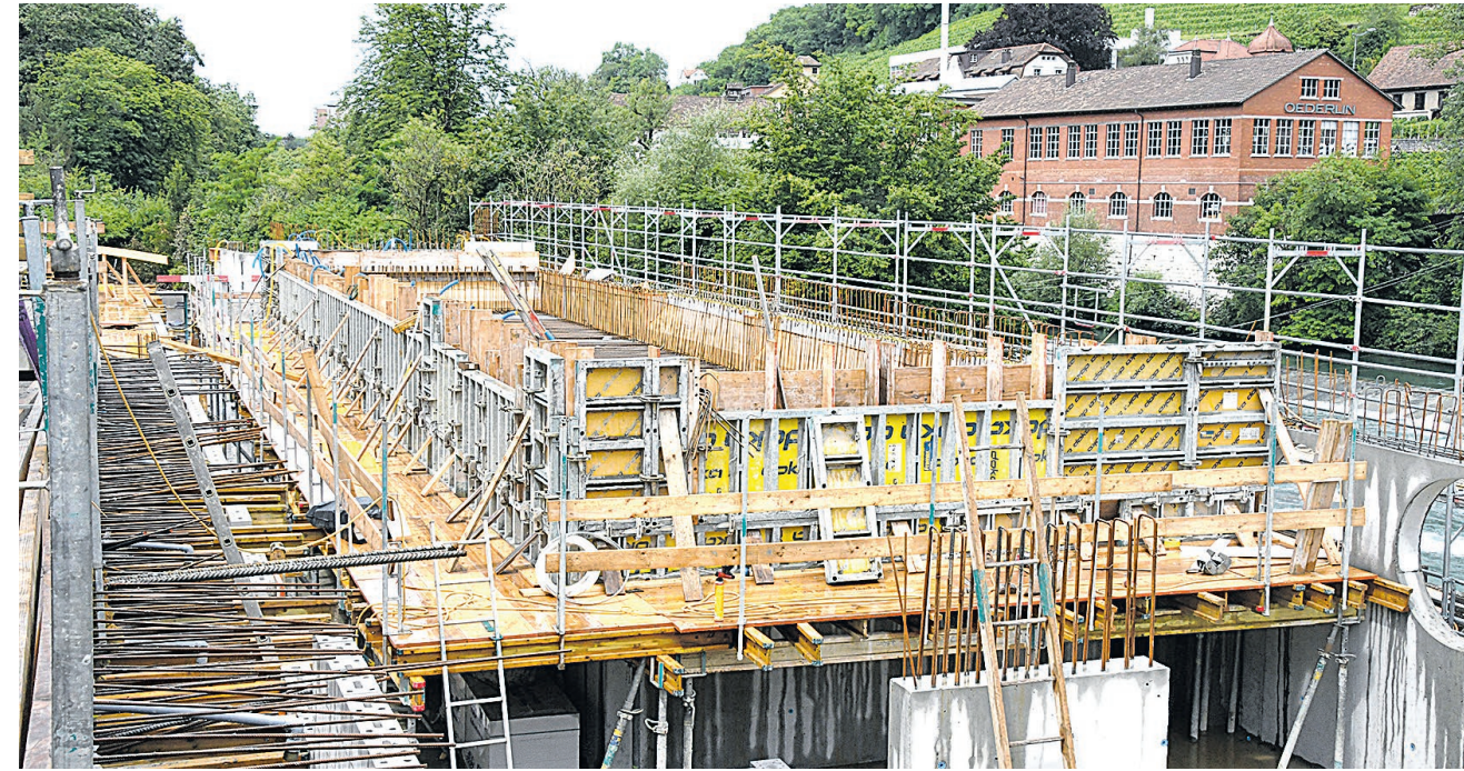
Vor einem Jahr befand sich dieser Aussenpool noch im Bau, heute ist er fertiggebaut. Er bietet beste Aussicht und wird ein Kaltwasserbecken ohne Thermalwasser sein.
