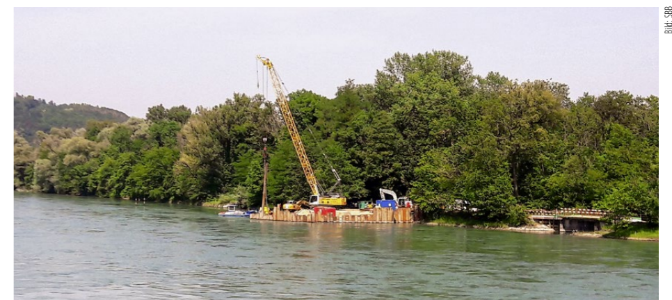
Als Installationsplatz musste erst ein Hafen gebaut werden, der ein Stück flussaufwärts liegt.
